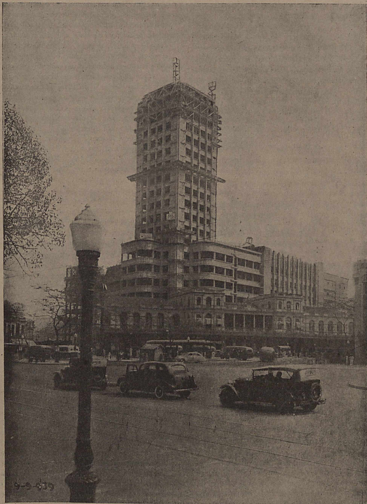
Um aspecto recente da construção da nova Estação Pedro II. Na frente, o prédio da antiga estação.
